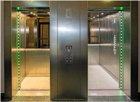
Blick in die neuen Aufzugskabinen
